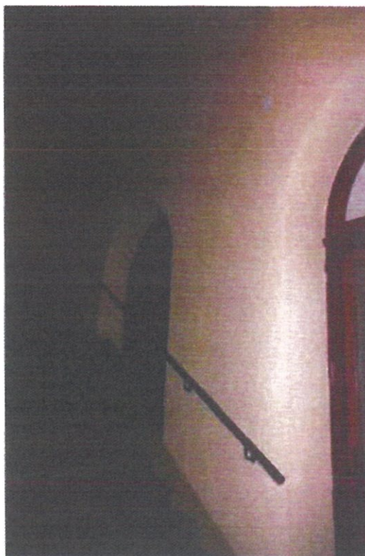
Fot. 10. Klatka schodowa w części pld. teatru, widoczne nierówności na tynkach po prowadzeniu wcześniejszej instalacji. 2017r.
