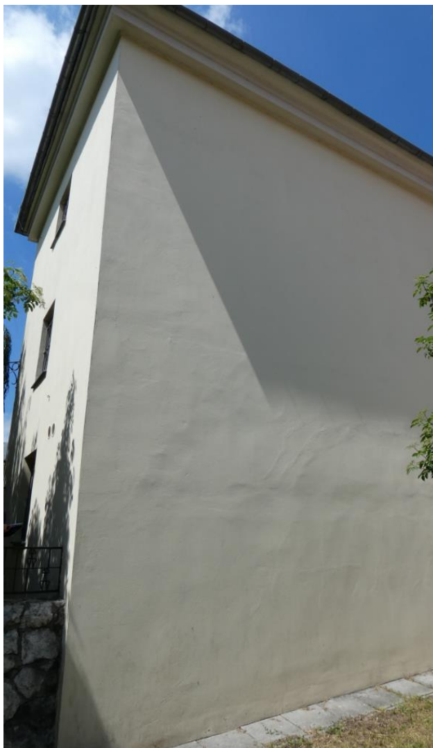
Fot.4 Widok od strony dziedzińca. Widoczny stan degradacji.
