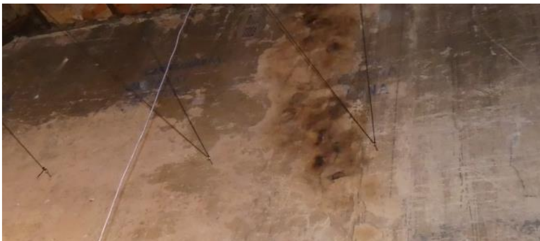
Fot.9 Wykwity na ścianie.
