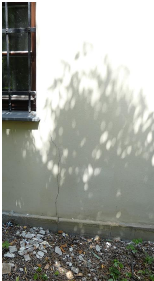
Fot.5 Ściana zewnętrzna Widoczne zarysowania
