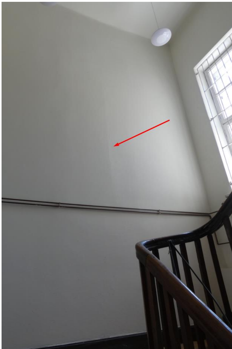
Fot.11. Widoczne zarysowanie w ścianie klatki schodowej.
