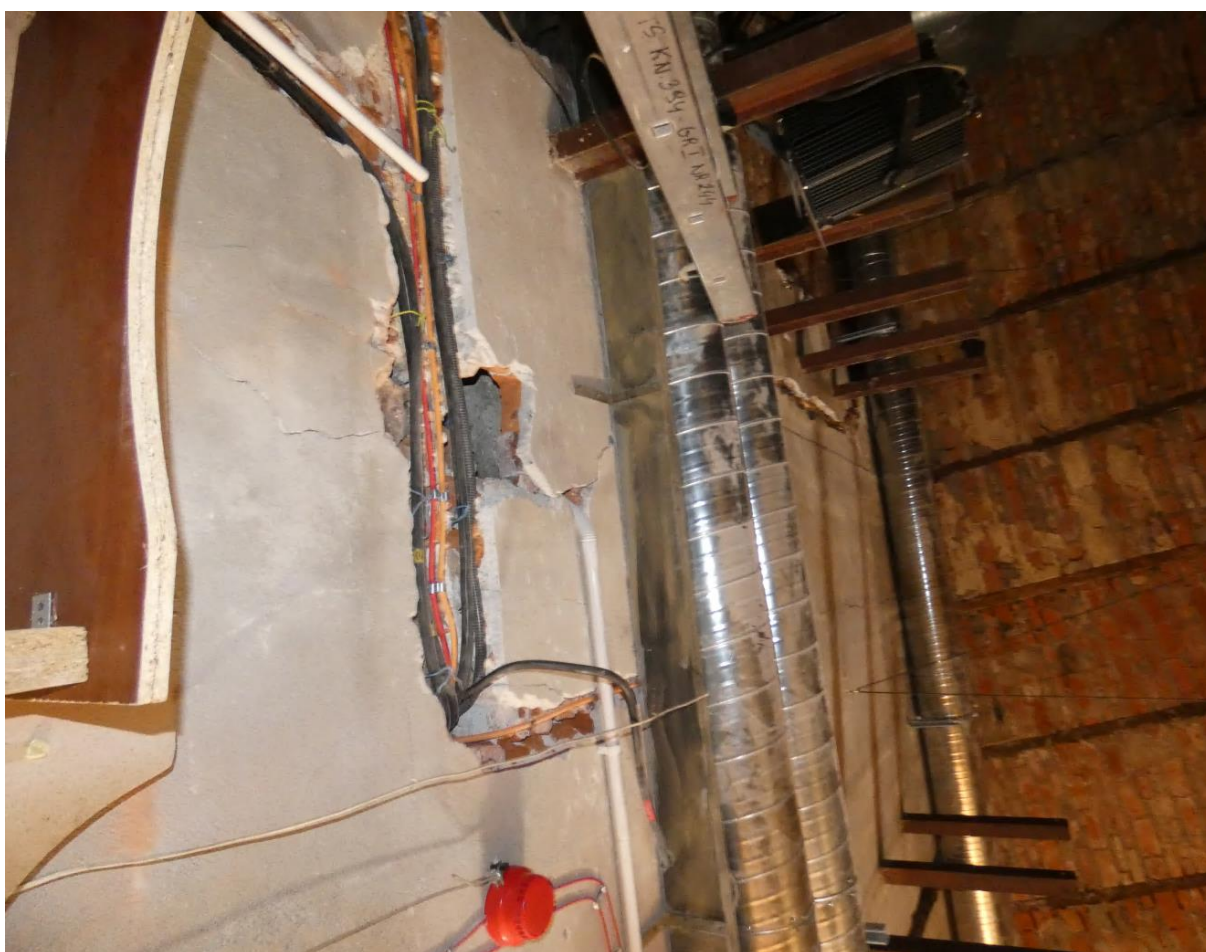
Fot.10 Widoczne zarysowania
