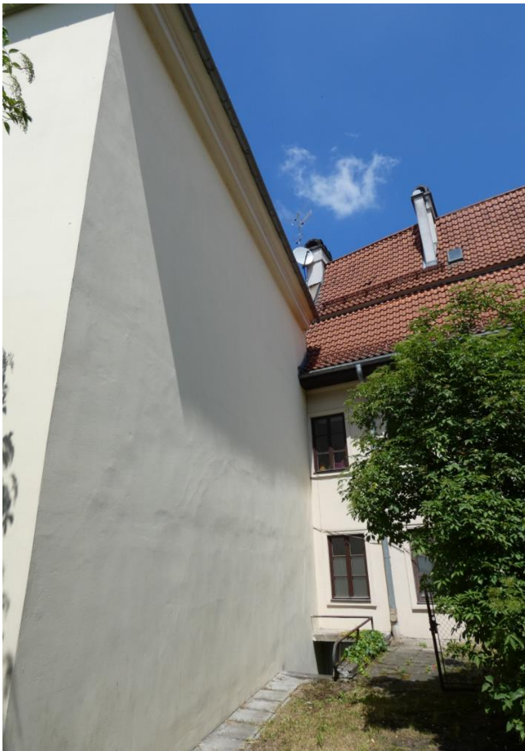
Fot.3 Widok od strony dziedzińca. Widoczny stan degradacji.
