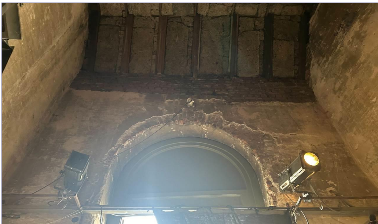
widok od strony wnętrza w zachowanym łuku(kształt pierwotny) naświetle, zamaskowane drewnem; zniszczenia stolarki - spękania płycin, liczne odrapania klamka i szyld historyczne
