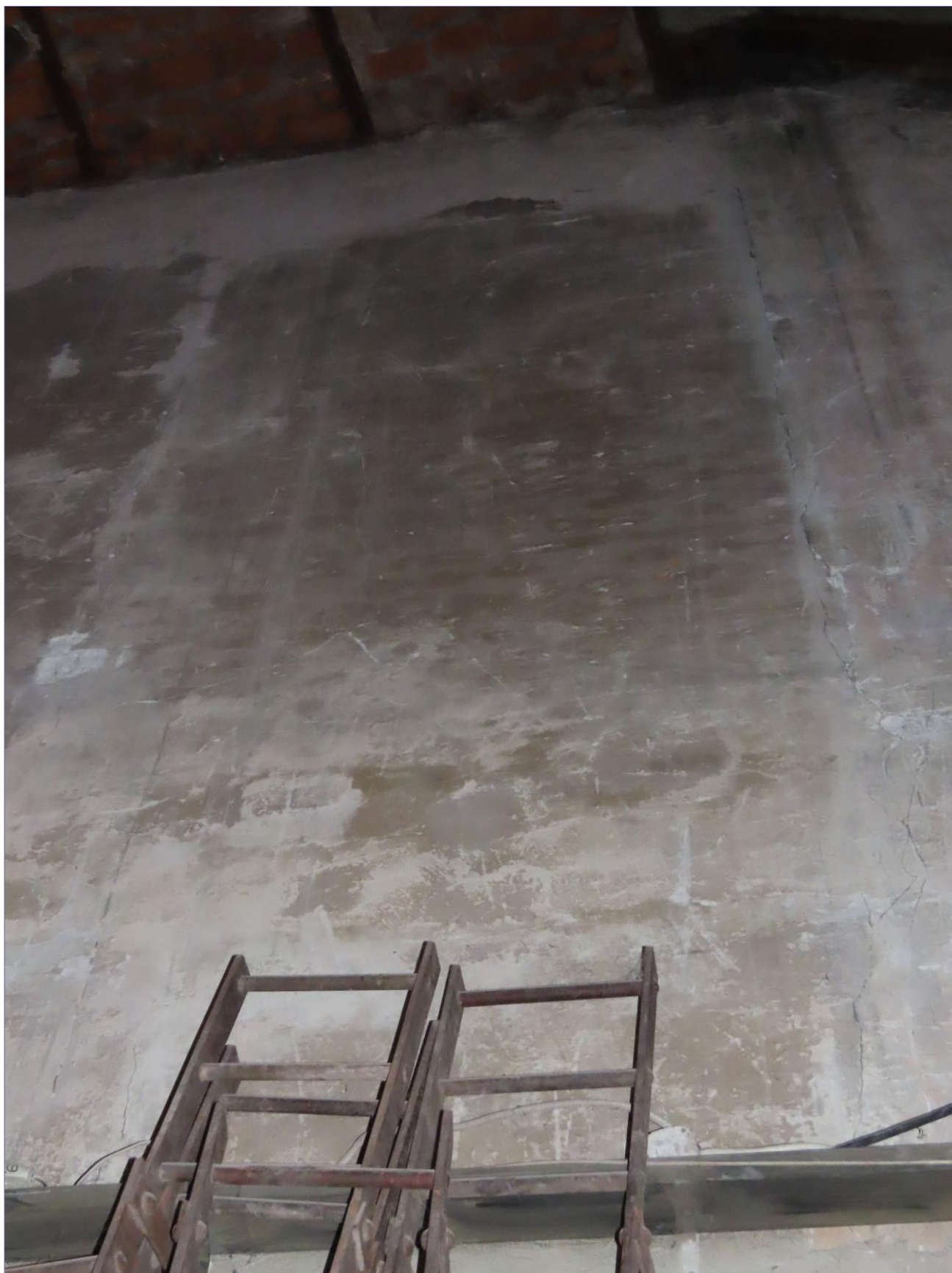
widoczne na ścianie od zachodu - w górnej części uzupełnienia tynków; zniszczenia wypraw- spękania, liczne zacieki, zadrapania, zabrudzenia, wysolenia, braki tynków w miejscach przekuć
