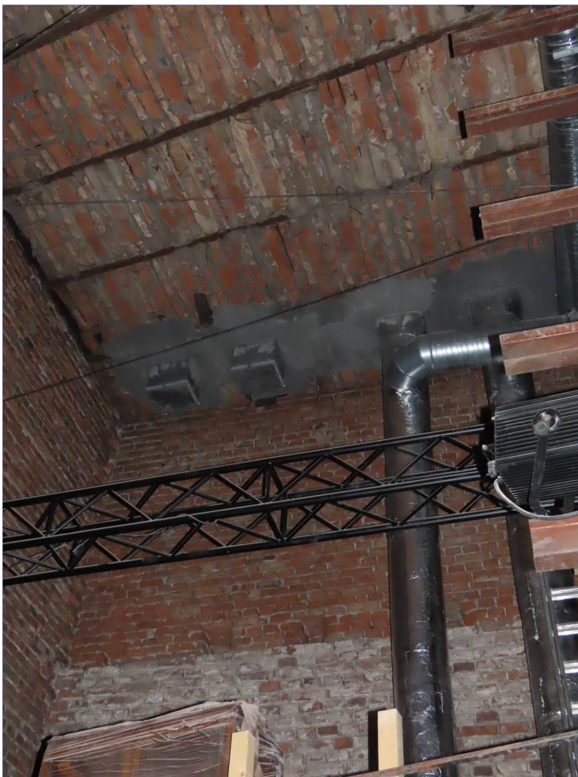
fragment strop Kleina - „techniczny charakter wątków i spoin” ubytki spoin, zardzewiałe elementy metalowe konstrukcji, nowe zaprawy naprawcze w miejscach przekuć przy wymianie i zakładaniu wszelkich instalacji technicznych i in., ściana południowa i fragmenty ścian zachodniej i wschodniej (od południa) z przemurowaniem wątków ceglanych (różne fazy i cegły) oraz pozostawieniem ich bez tynków
