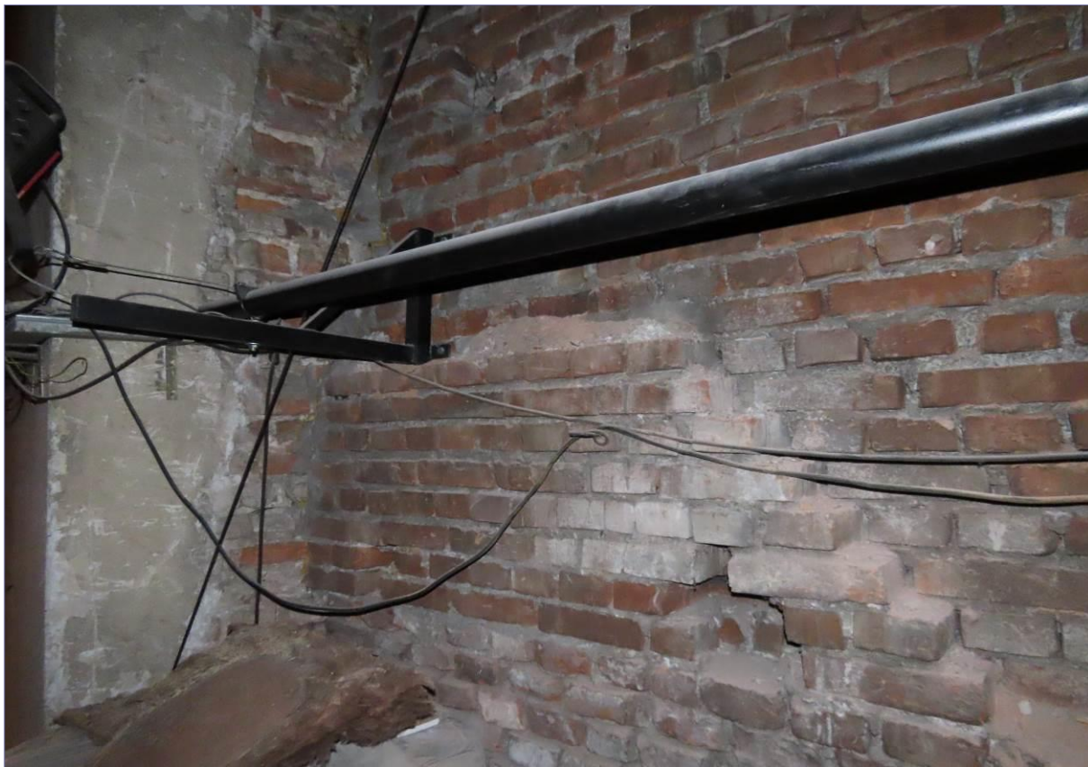
stan spoin i cegieł - zakurzenie i zabrudzenie, lokalne przymurowania
