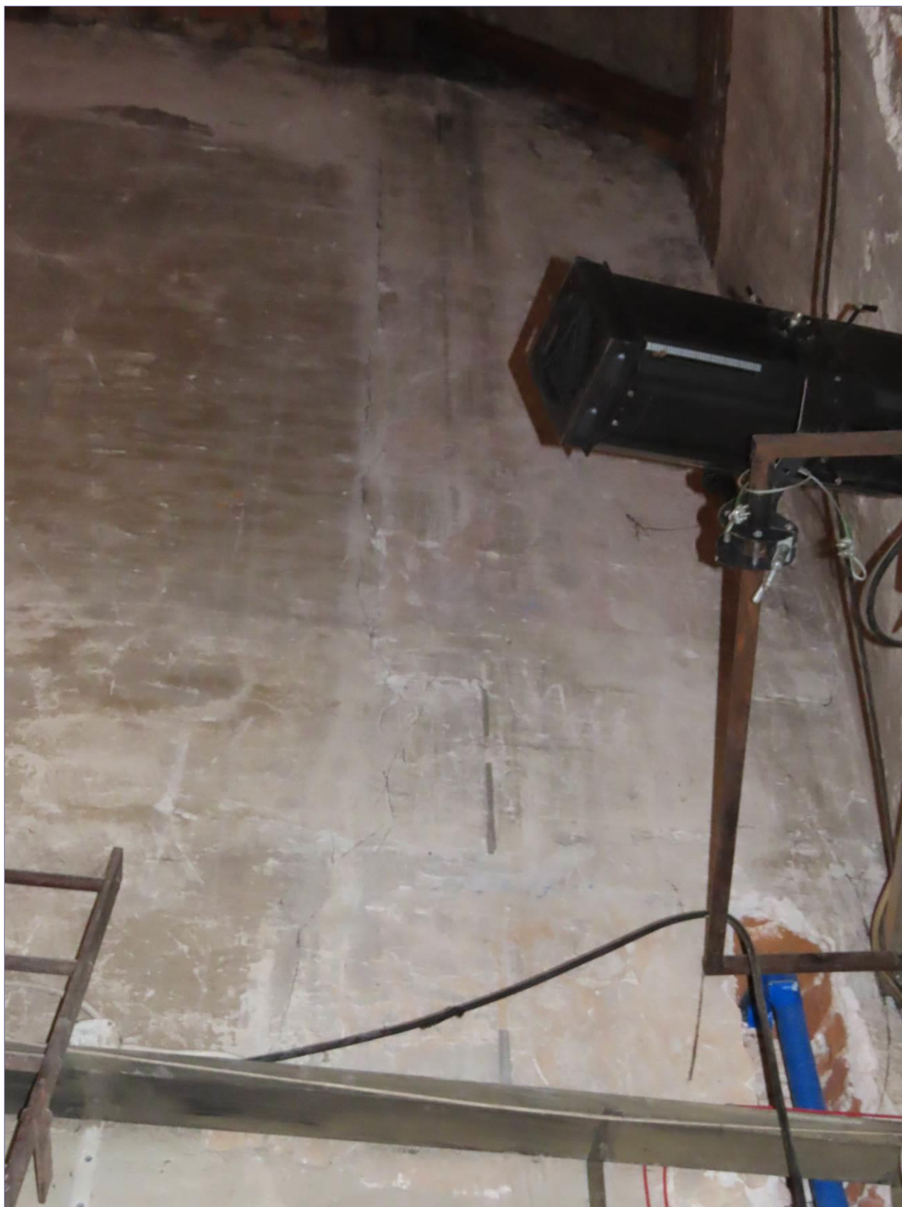
widoczne na ścianie od zachodu - w górnej części uzupełnienia tynków; zniszczenia wypraw spękania, liczne zacieki, zadrapania, zabrudzenia, wysolenia, braki tynków
