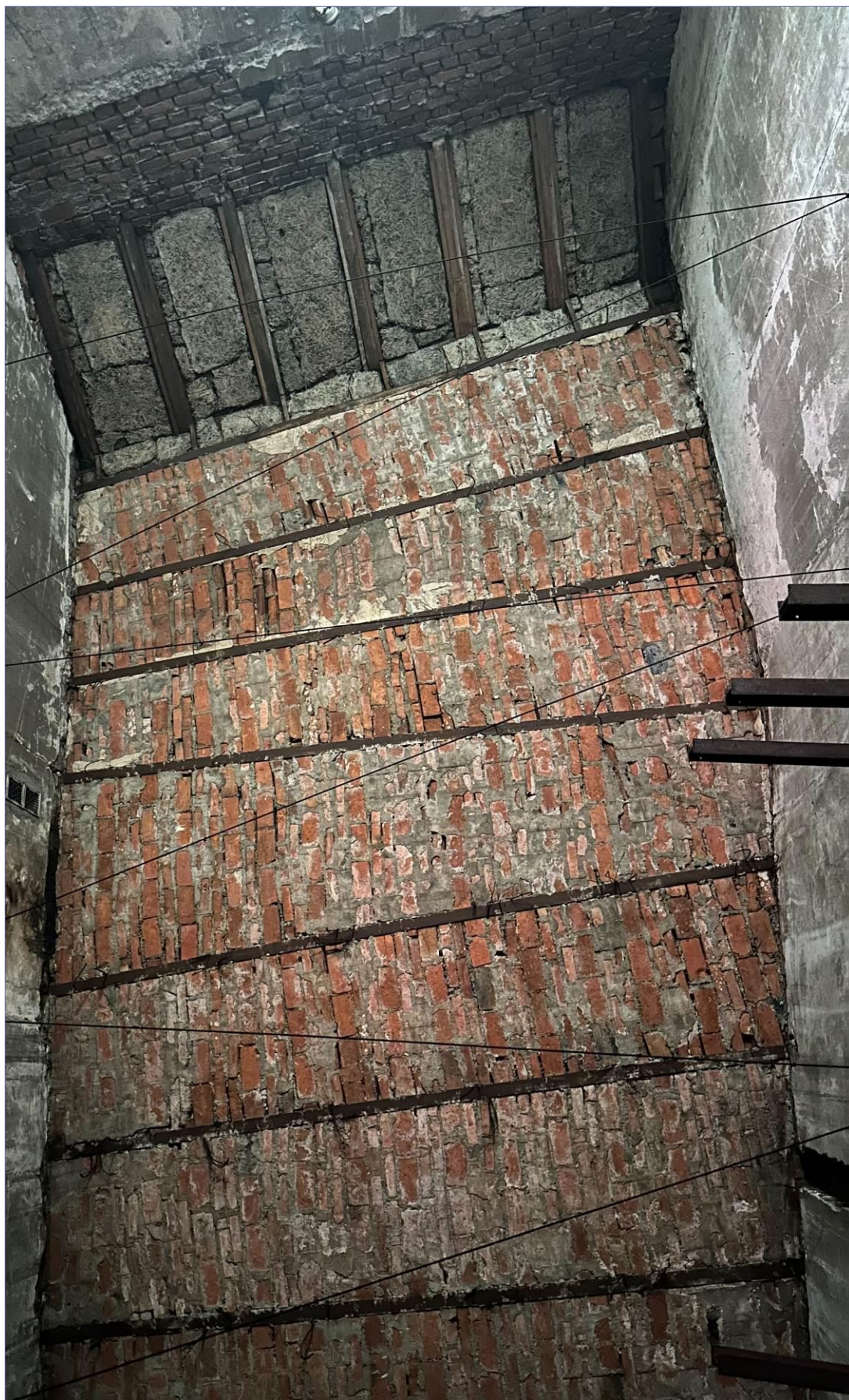
widok ogólny stropu Kleina - „techniczny charakter wątków i spoin” ubytki spoin, zardzewiałe elementy metalowe konstrukcji, pęknięcia tynków - materiałów występujących pomiędzy belkami w części sklepienia
