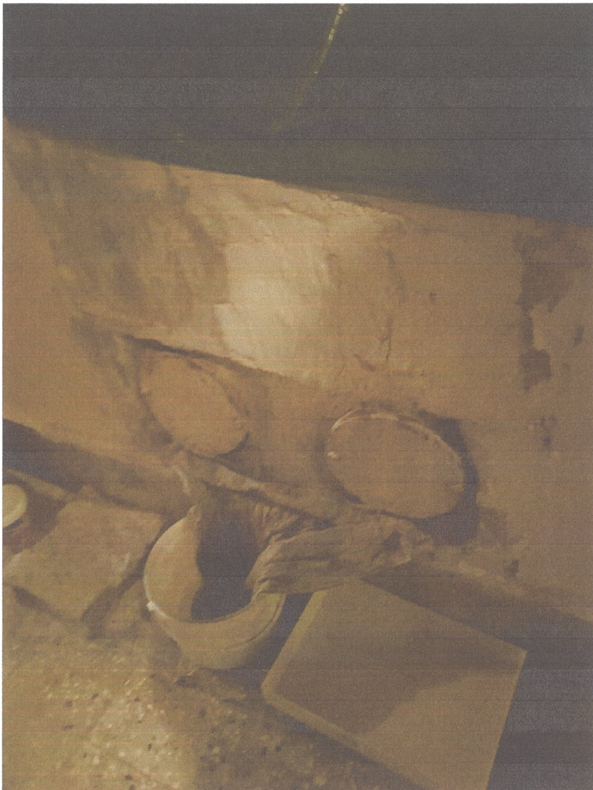
katastrofalny stan tynków i wpustki poszczególnych pionów z których stale sączy się woda; zabezpieczenie podstawiane pojemniki ze szmatami; widoczna degradacja i zawilgocenie tynków
